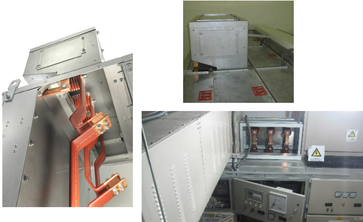
Módulo adicional sobre el techo
